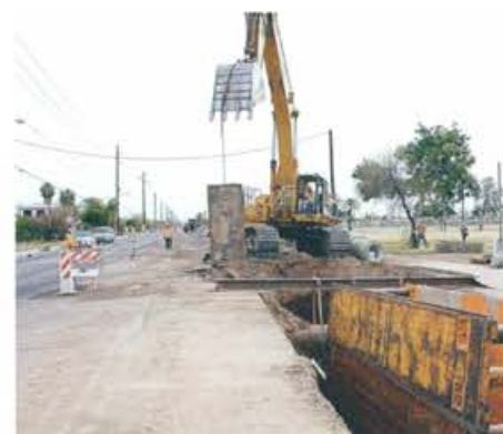
Broadway Sewer Pulice, EEUU. 2015
