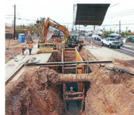
Broadway Sewer Pulice, EEUU. 2015
